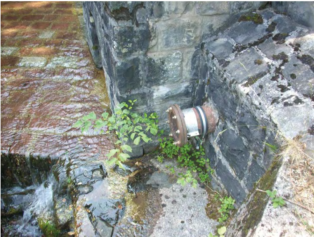
VISTA 10 – TUBAZIONE SCARICO DI FONDO ACQUE DE22
