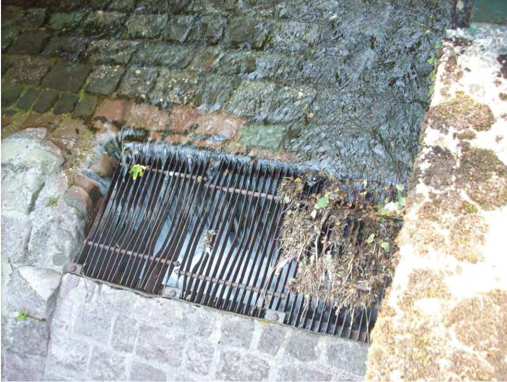
VISTA 9 – GRIGLIA METALLICA DI PRESA ACQUE
